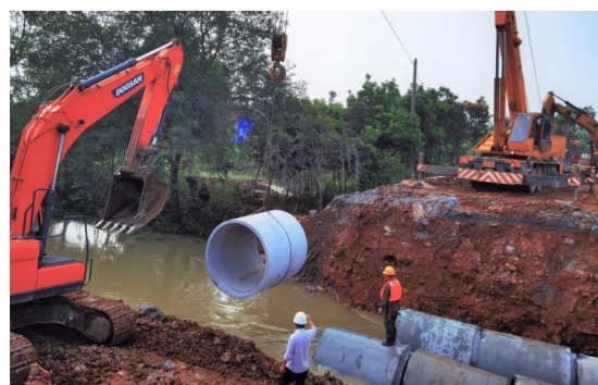
近日,湖北荆门突降暴雨,中建五局土木公司207国道项目迅速组织挖机设备40余台,对涨水河道、沟渠增设排水管道,组织农田排水,出动卡车帮助村民转运物资,保障了村民生命财产安全。(刘重、雷叶)
