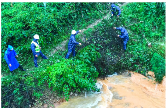
7月8日下午,中建交通江西公司景德镇项目附近铁路低洼处蓄水严重,危及铁路运行安全。项目部紧急配合铁路部门开挖沟渠,增开排水口,将积水导入附近涵洞,及时解决隐患。(交通)
