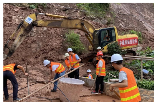
7月1日凌晨,遵义桐梓县和习水县境内爆发山洪,S302习新省道出现15余处严重山体滑坡,中建四局正习15标项目部第一时间紧急驰援受灾一线。(蒋治勇)
