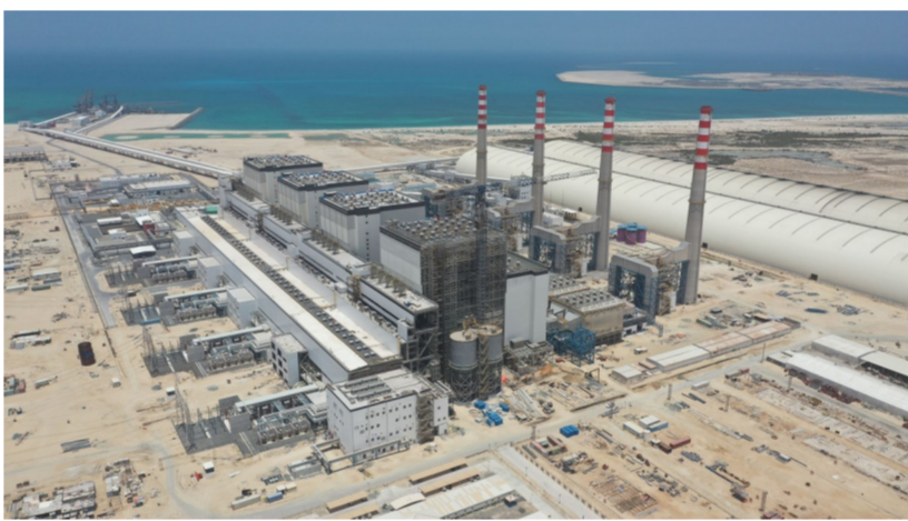
由中建三局二公司承建的迪拜哈斯彦电站项目4号机组并网成功。迪拜哈斯彦电站项目位于迪拜杰布布哈里区,是世界上第一个实现双燃料满负荷供电的电站。项目4台机组全部投入商业运行后,将为迪拜提供20%的电力能源。项目是“一带一路”国际合作重大工程,也是中东首个清洁能源电站。(任艳峰)
